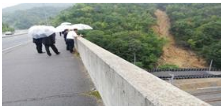
八本松変電所付近土砂崩れ現場
